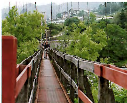
老朽化に伴い通行止めになっている西中通学橋
