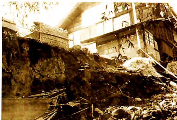
昭和36年4月/寺沢地区内の亀裂(段差2mを超えた)
