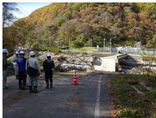
橋梁災害状況
