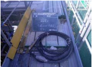
※予備のパイプレータ
